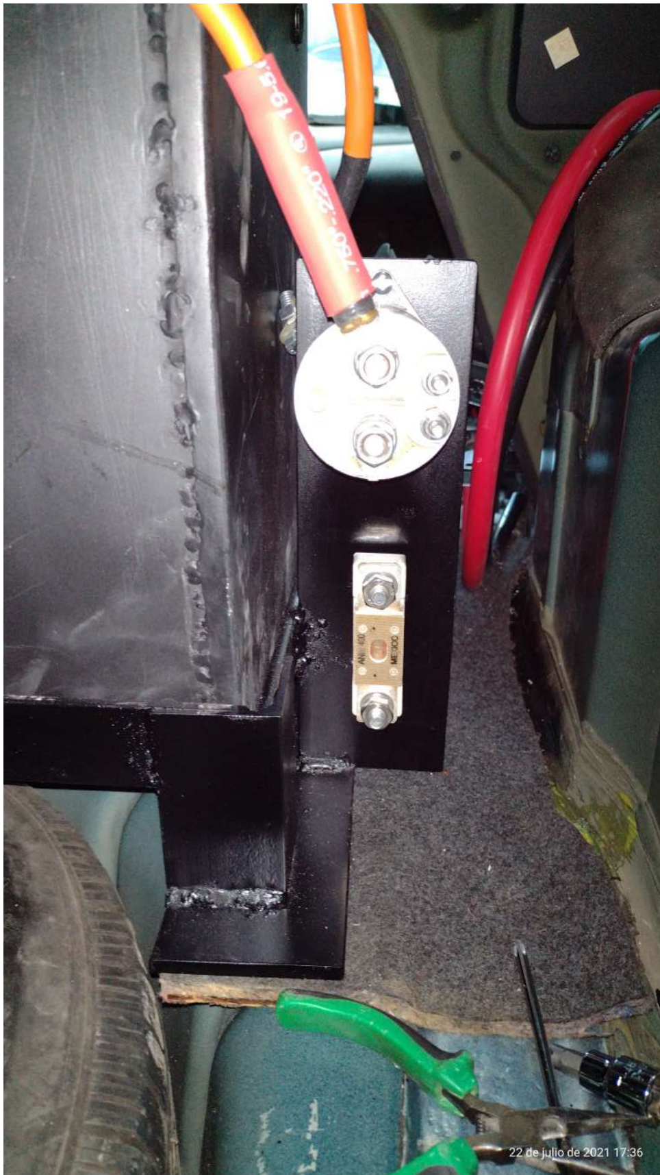
Figura 7.24: Ubicación del contactor y portafusible
