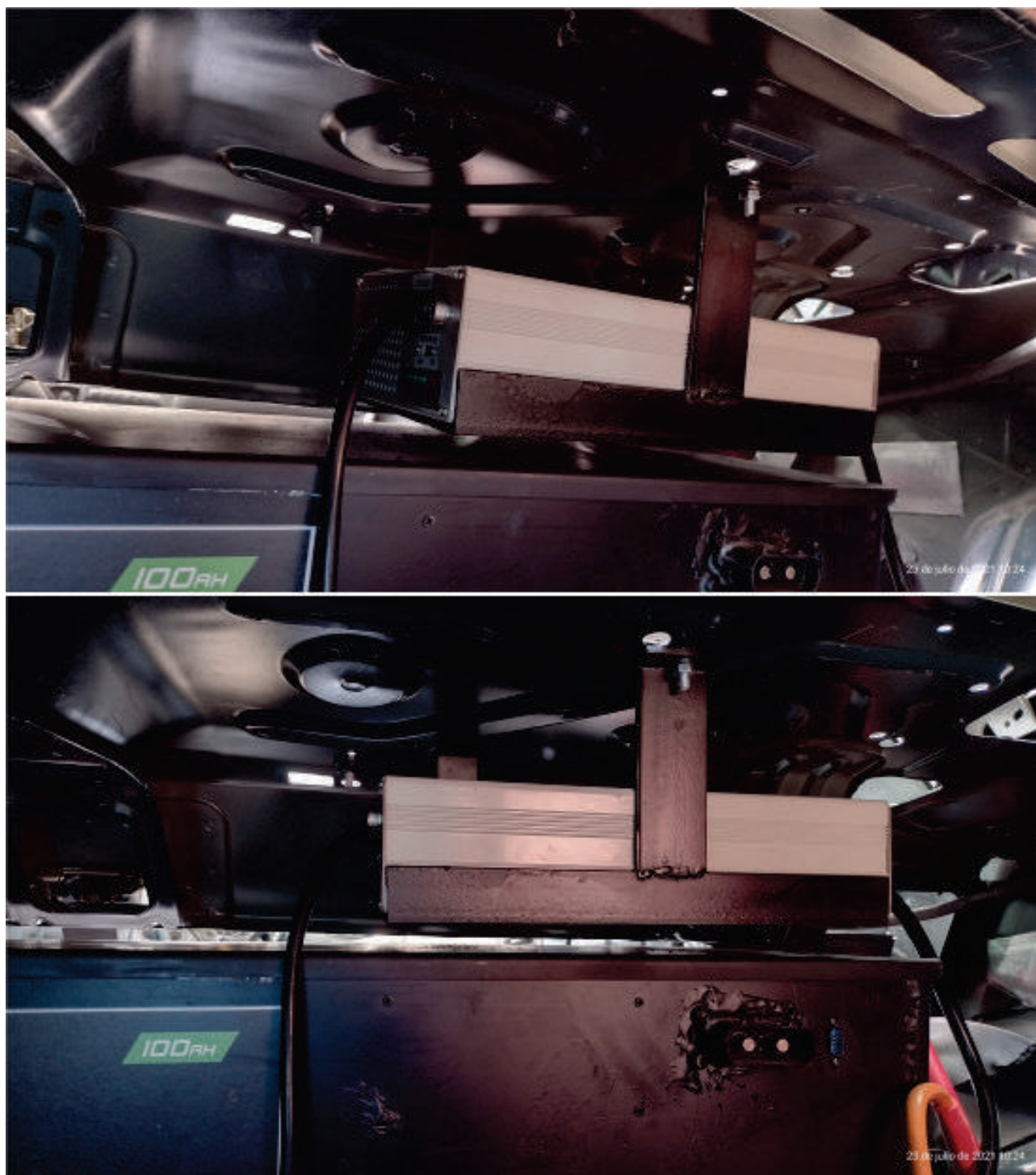
Figura 7.25: Ubicación del cargador de baterías
