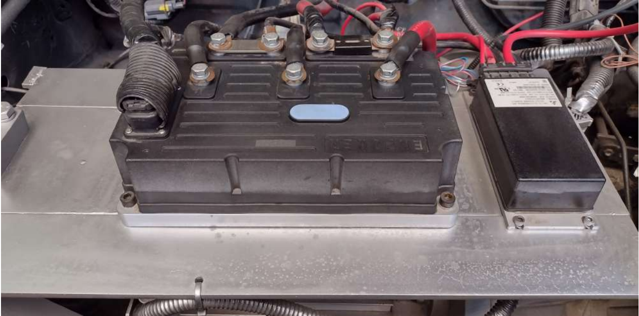
Figura 7.33: Convertidor DC - DC a un costado de la controladora
