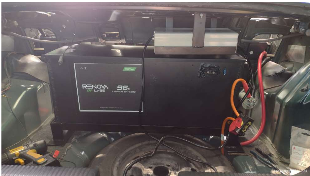
Figura 7.26: Instalación completa del banco de baterías y componentes auxiliares
