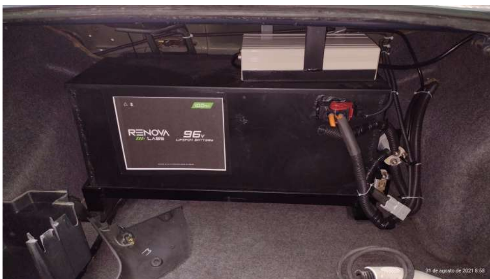
Figura 5.3: Imagen representativa de un banco de baterías y su cargador
